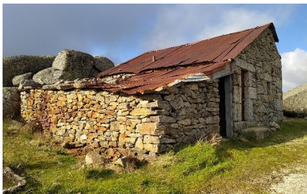
Acentuada degradação: Casa dos Baldios
