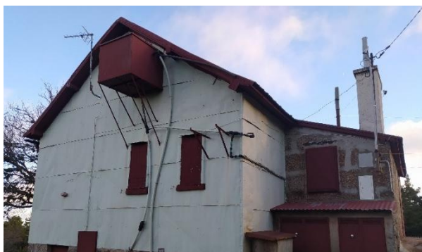
Reservatório, antenas e cablagem: Casa do Seixo
