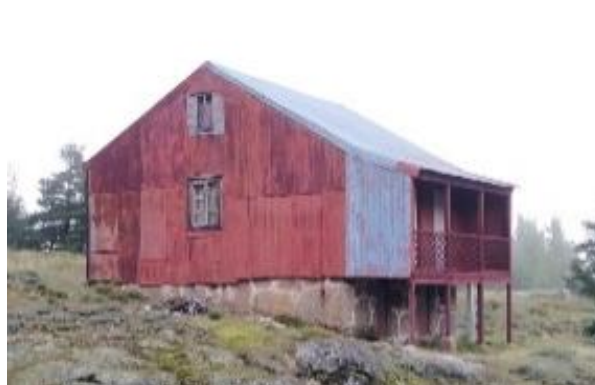
A necessitar de obras de conservação: Casa dos Caçadores
