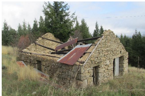
Acentuada degradação: Observatório Meteorológico - Casa da Burra
